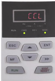
图 4-4 故障告警显示状态图（CCL：编码器断线故障）
